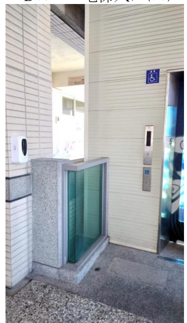
D0514-1電梯入口(70)
